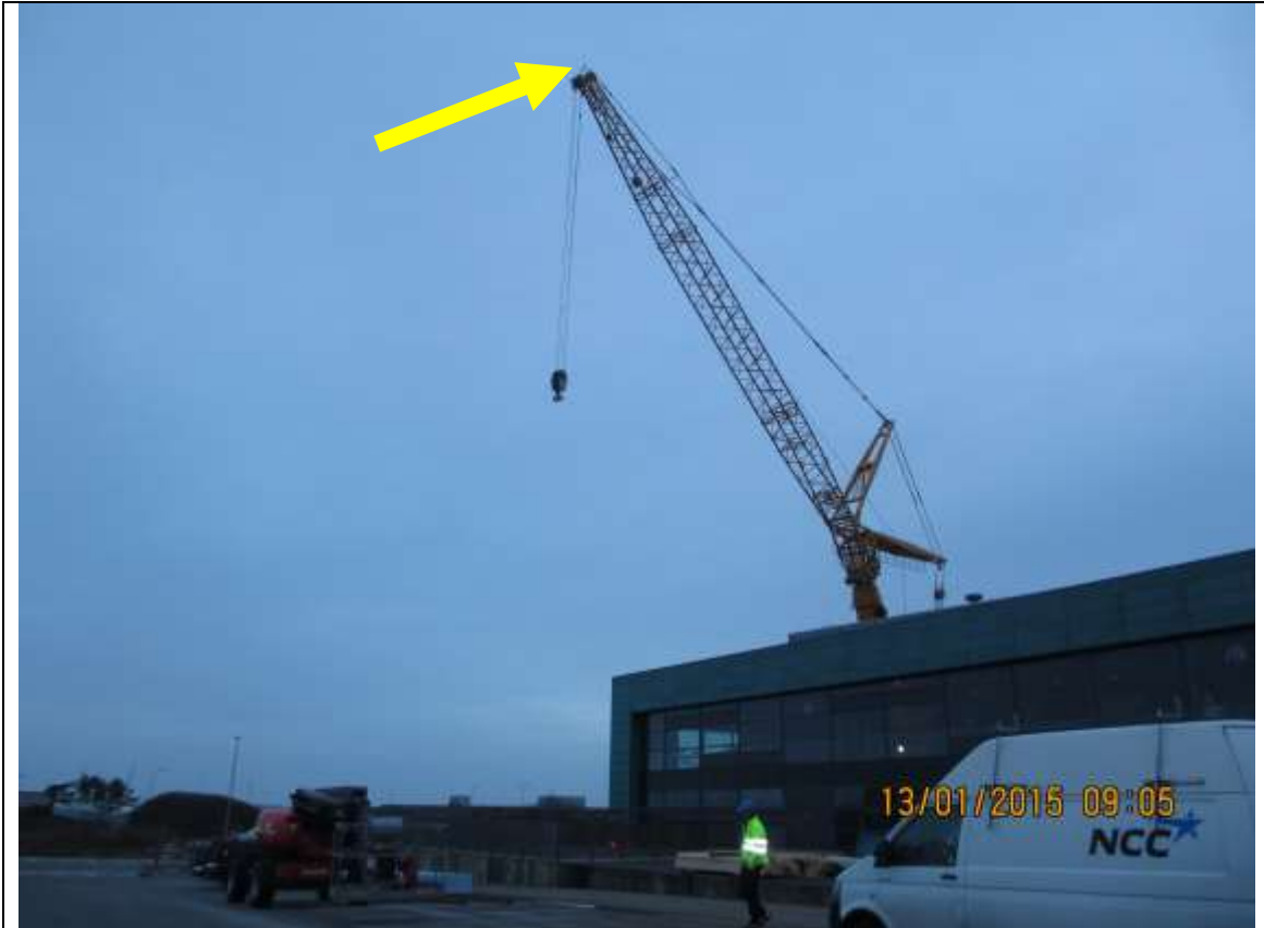
Hovedkranen har monteret en vindmåler på udlæggeren, som begrænser kranens arbejde ved en vindhastighed over 9 m/s.
