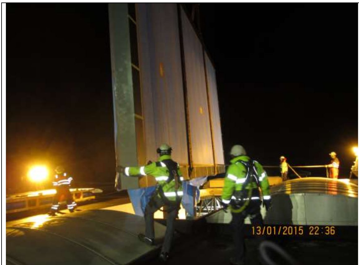
Team fra NCC har åbnet tagsektionen og panoramaruden løftes ind, da et vindhul viser sig kl. 22.25.
