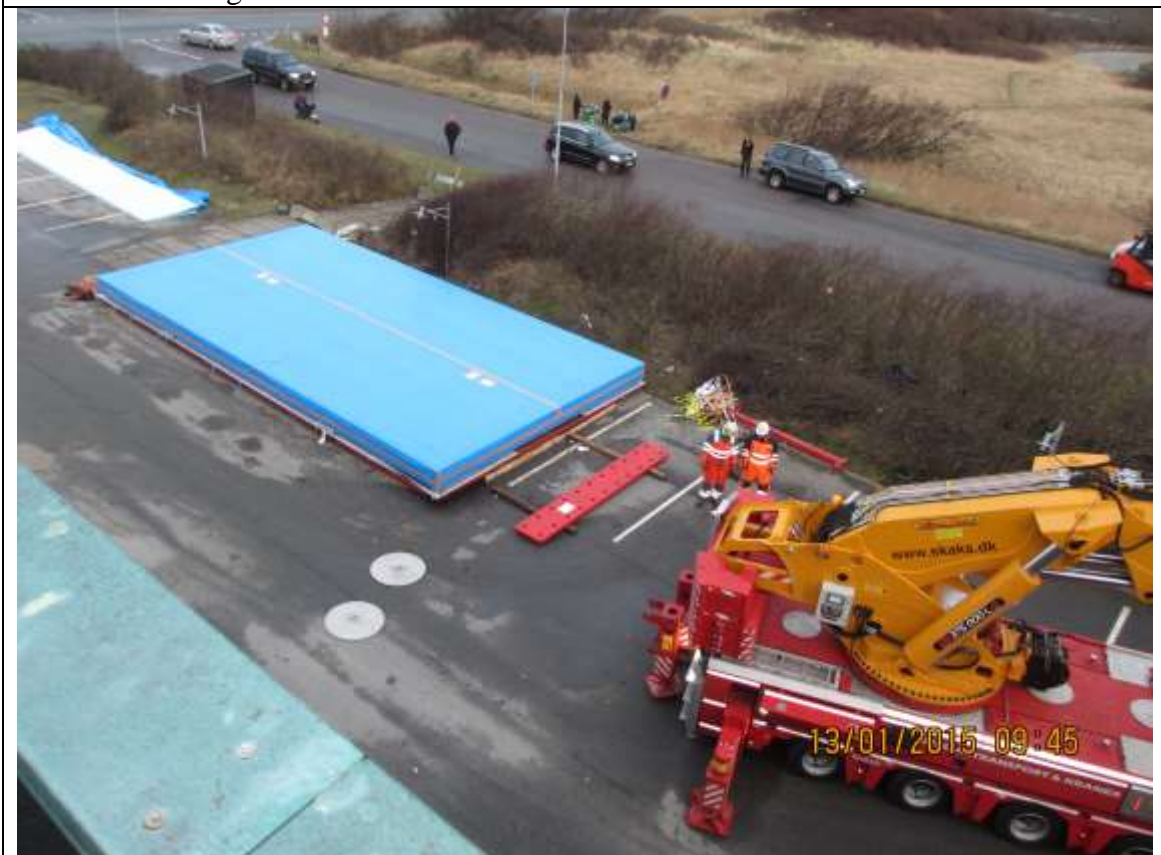
Ruden ligger med vandsiden mod transport-rammen og toppen mod NØ. Vindhastighed over 15 m/s udsætter løftet.
