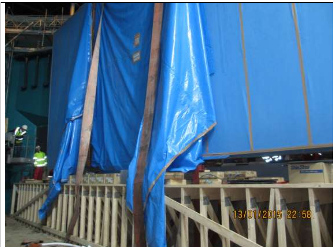
Underkanten landes på kantprofil med indlæg uden bemærkning.
